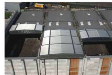
La typologie de panneaux photovoltaïques utilisés permet d'envisager de faire migrer une toiture classique vers une toiture solaire. Ainsi, ce client du port de Neuss, en Allemagne, qui est équipé de quinze bâtiments de stockage à toit découvrable de 15x40 m envisage ce type d'évolution. Pour les projets neufs, l'orientation du bâtiment est naturellement optimisée.
